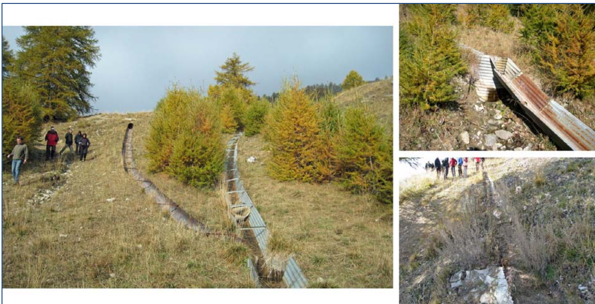
Abb. 6: Ableitung des durch Entwässerung gewonnenen Wassers.
