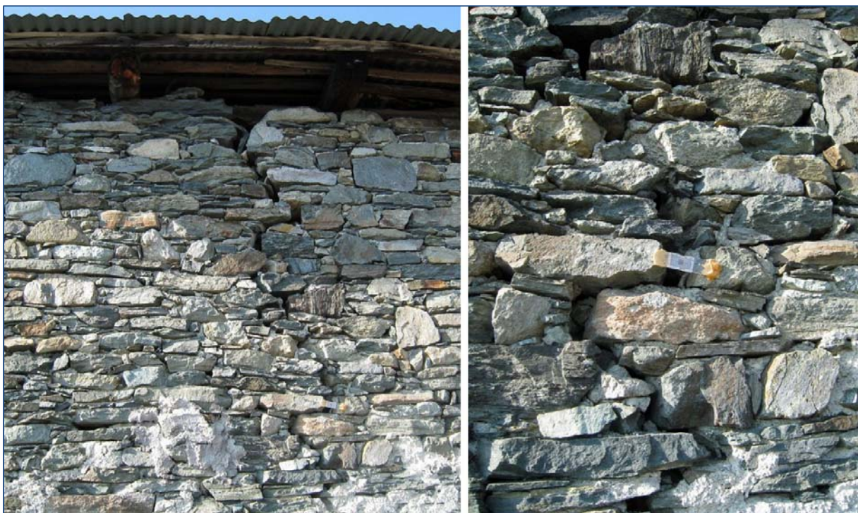
Abb. 20: Schäden an einem Haus wenige Meter vor der Stirn der Rutschung von Sampeyre. Sowohl das Bewohnen, als auch Reparaturen an diesen Häusern sind verboten.
